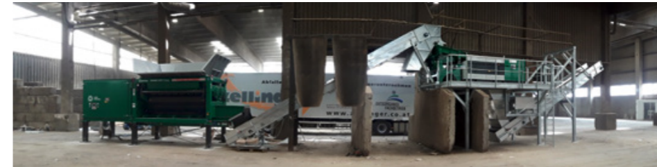
Die Anlage trennt automatisiert Holz von anderen Materialien wie zum Beispiel Metall. Bild: ESA
